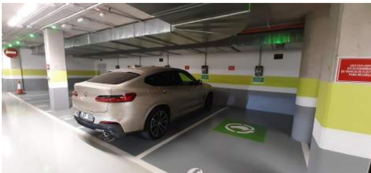
Ilustración 86. Plaza reservada a vehículos eléctricos.
